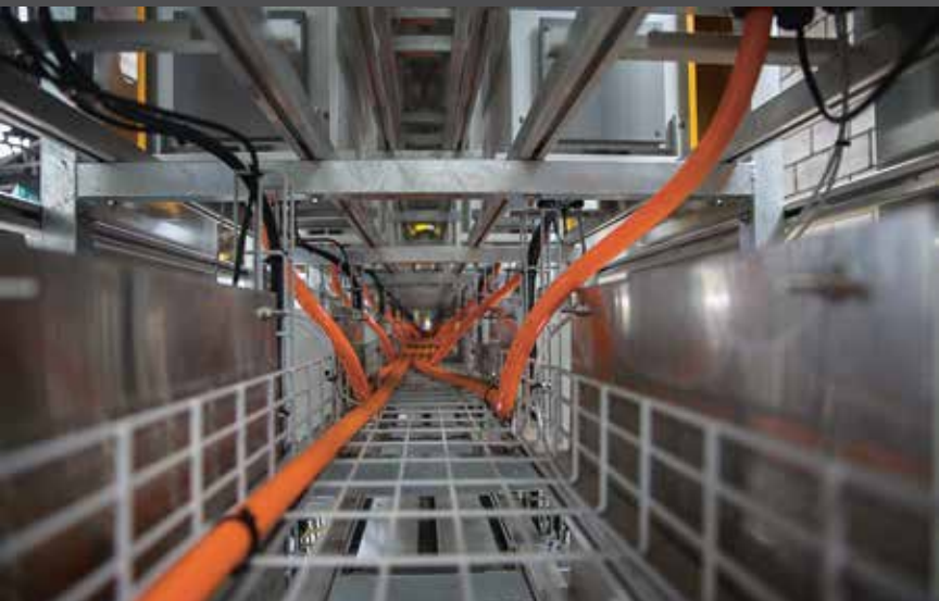
Detailansicht der Wechselrichter-Verkabelung
